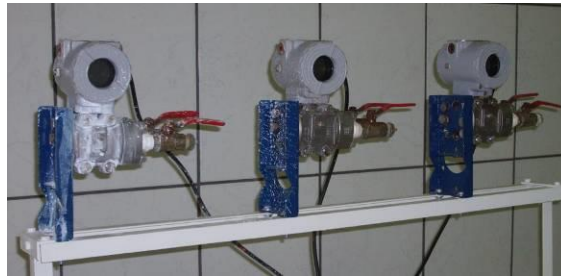
Figura 6: Medidores de pressão diferencial (SMAR).
